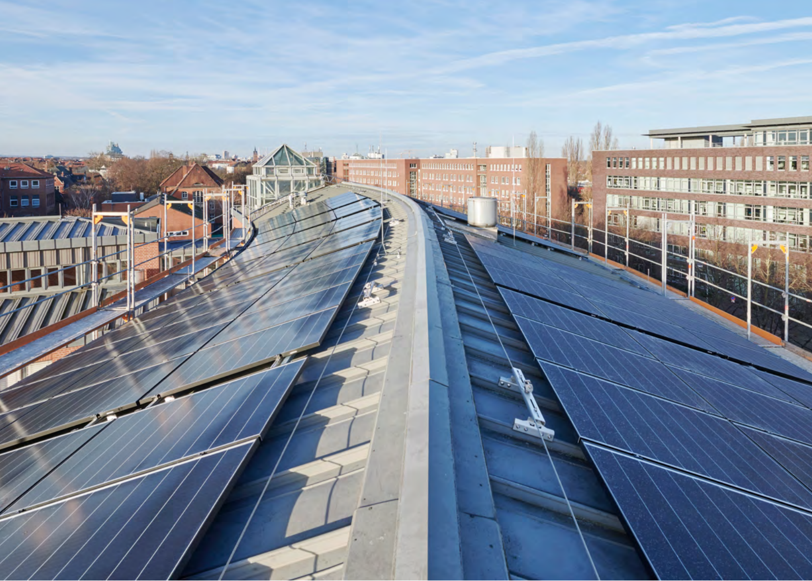
Photovoltaikanlage auf der Kurt-Schumacher Kaserne, Hannover
